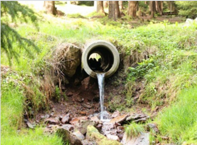
Rohr und Absturz sind für Kleintiere unüberwindbar.
